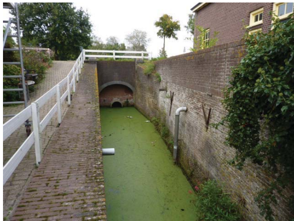
Ontwateringssluis achter Ambt van Neykerk
